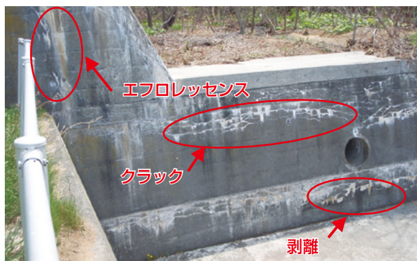
写真-1 えん堤の劣化状況
