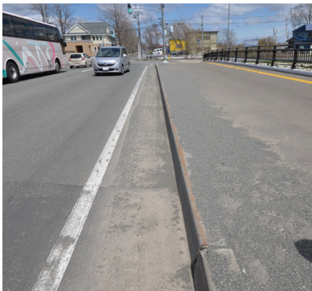
写真-7 鋼製縁石腐食状況
