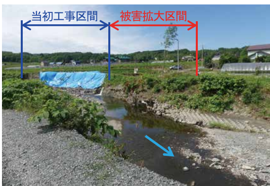
写真-2 工事着手前に被害拡大(内未成)
