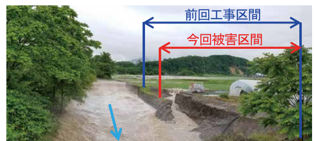
写真-1 かごマット(多段)の被災状況(未満災)
