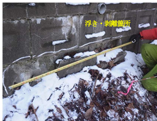
写真 2-2 擁壁損傷状況
